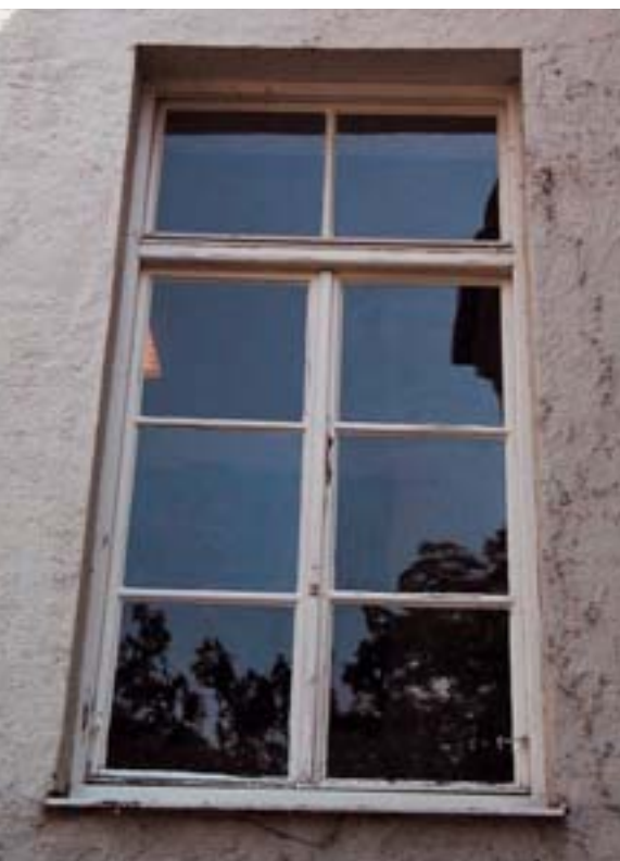
Bei der Sanierung alter Fenster ist Vorsicht geboten: häufig enthalten alte Fensterbeschichtungen Blei, das bei unsachgemäßem Umgang die Gesundheit gefährden kann.
