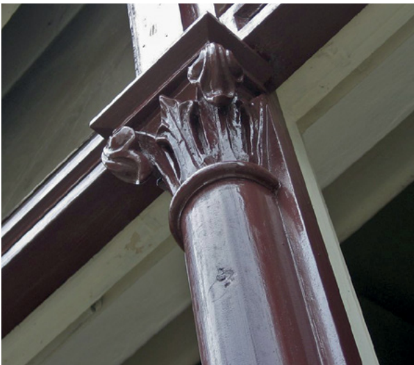
Mit VSK Abbeizverfahren restauriertes Fensterdetail, Museum für Völkerkunde München (Foto: Hans Ritt)
